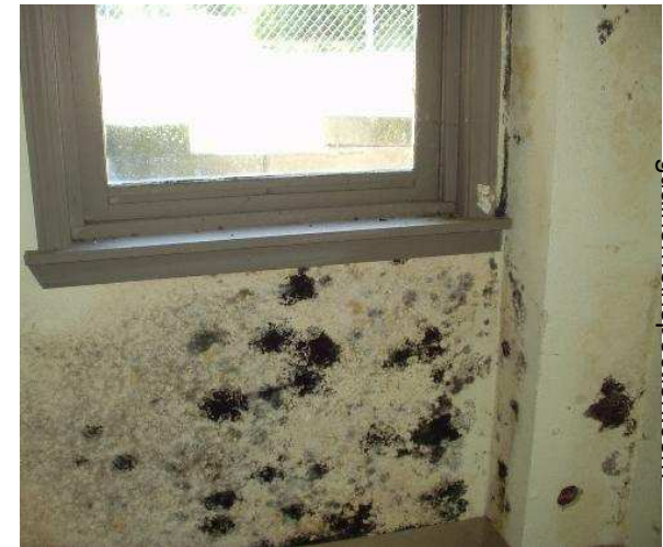
Schimmelflecken an der Wand
