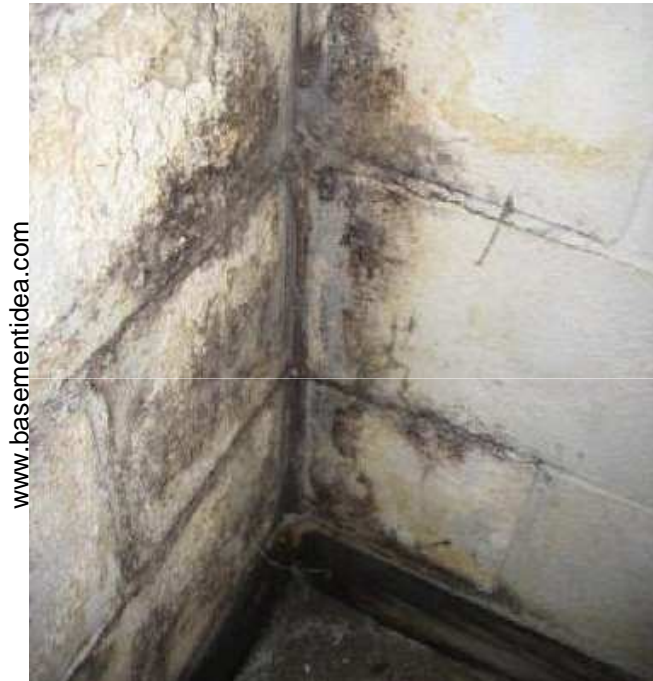
Schimmelbelag der Wand im Keller
